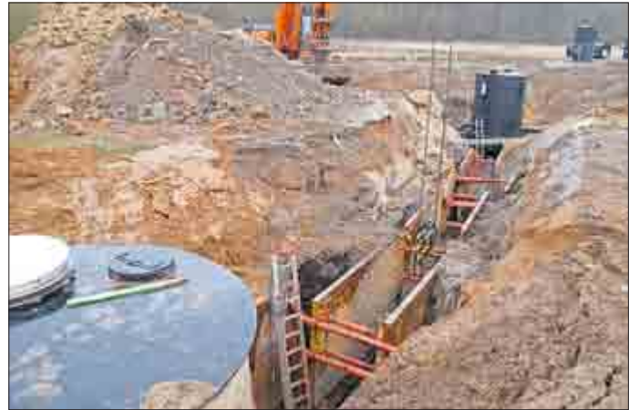
Abbildung 1: Herstellung einer Liniendränage zur Wasserfassung im Gessental zwischen zwei Funktionsschächten. Dazu gehören vor allem die Errichtung weiterer Liniendränagen im Bereich der Wegkreuzung mit dem Gessenbach (Schutzhütte), die Erweiterung des unterirdischen Pumpenvorlagebehälters unmittelbar an der Pumpstation und die Verwahrung einer Altbohrung durch großkalibriges Überbohren ca. 100 m westlich der Pumpstation. Deshalb wird es im Gessental noch bis Mitte 2017 2 bis 3 Baustellen gleichzeitig geben. Die neue Druckrohrleitung aus dem Gessental zur Wasserbehandlungsanlage ist bereits fertiggestellt.
